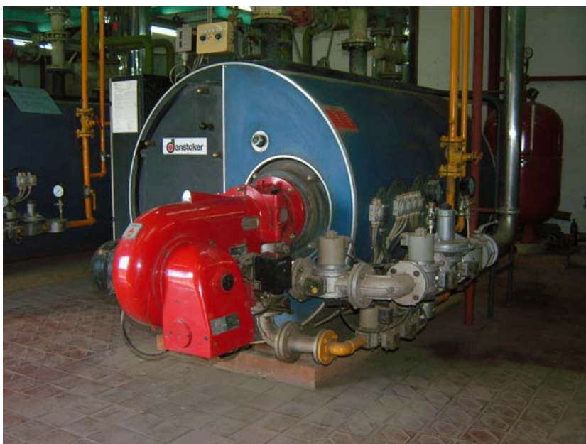
Фото 1. Котельная с 2-х газовыми горелками Weishaupt G7.
